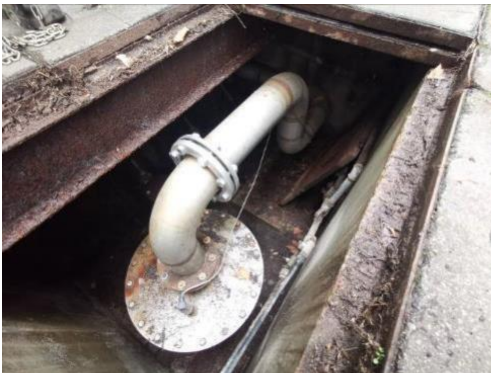
Tête étanche du forage de réinjection, boulonnée avec capteur de pression
